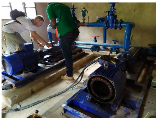
Station de pompage Munyana – Groupes de pompage
