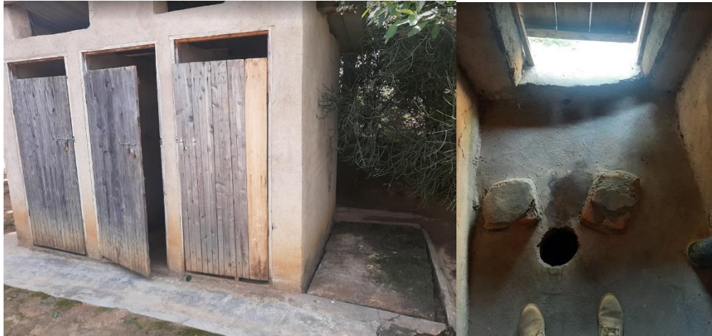
Latrines collectives du bureau Secteur de Rusasa
