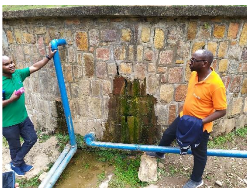
Station de pompage Munyana – Bâche de reprise
