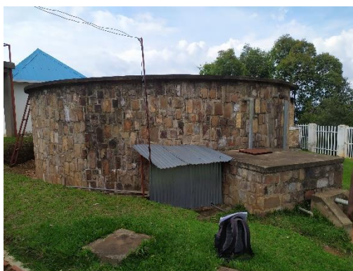
Réservoir de tête
